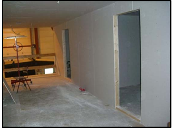
Innerste dør er inngang til kontrollrom, nærmeste dør inngang til anhuker/signalgiver stasjonene
