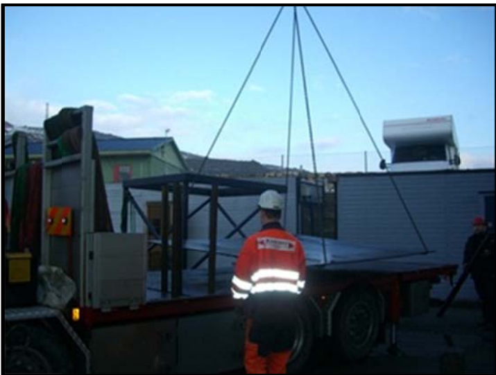
Stålplate som skal ta opp tyngden fra fundament og cabin blir heist på plass.
