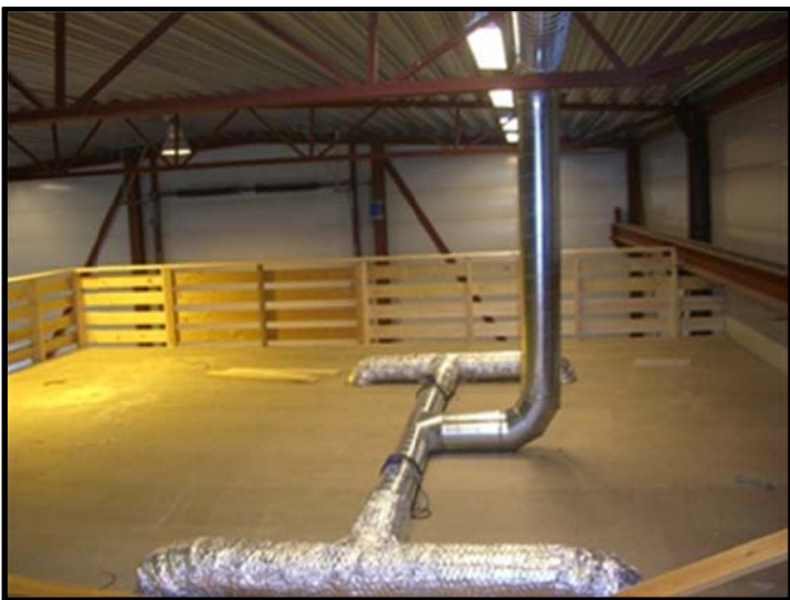
God ventilasjon blir tilført via vårt nye ventilasjonsanlegg tilhørende nybygget.
